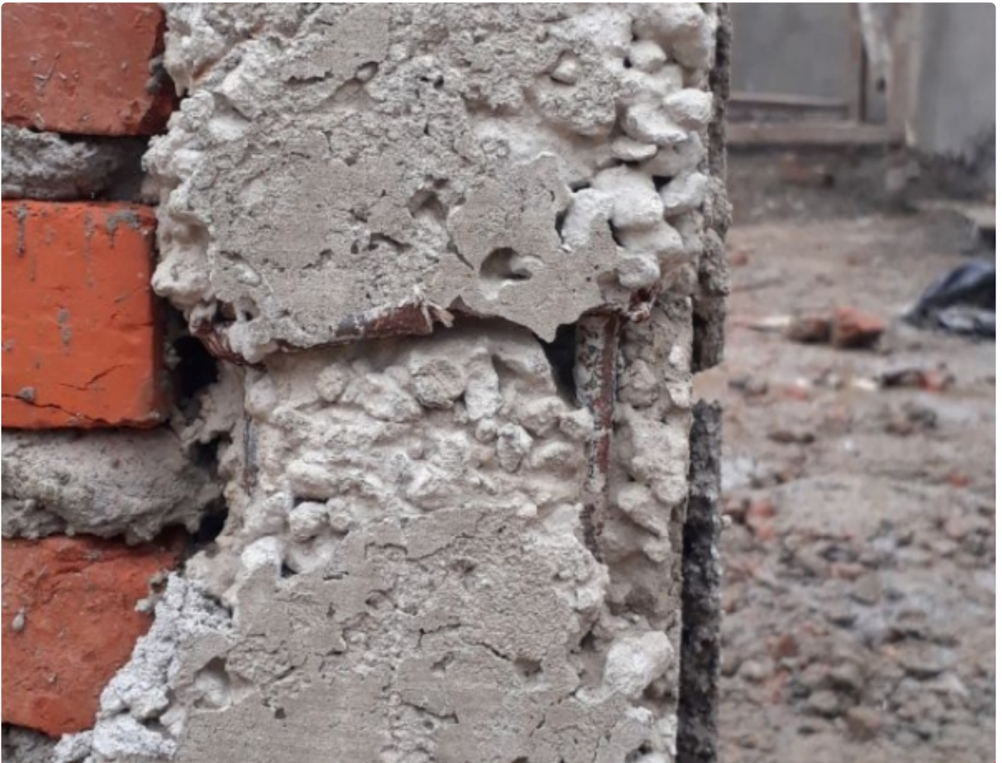
Rawan ambruk, kondisi kolom proyek SDN Putat Nutug 03 terlihat keropos
